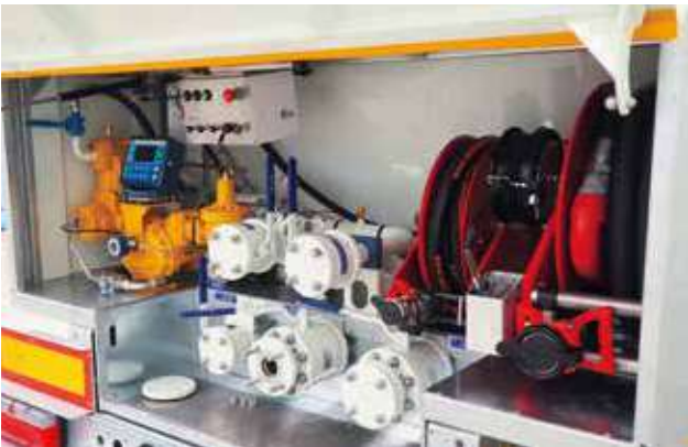
Installation de déchargement postérieur service distribution
